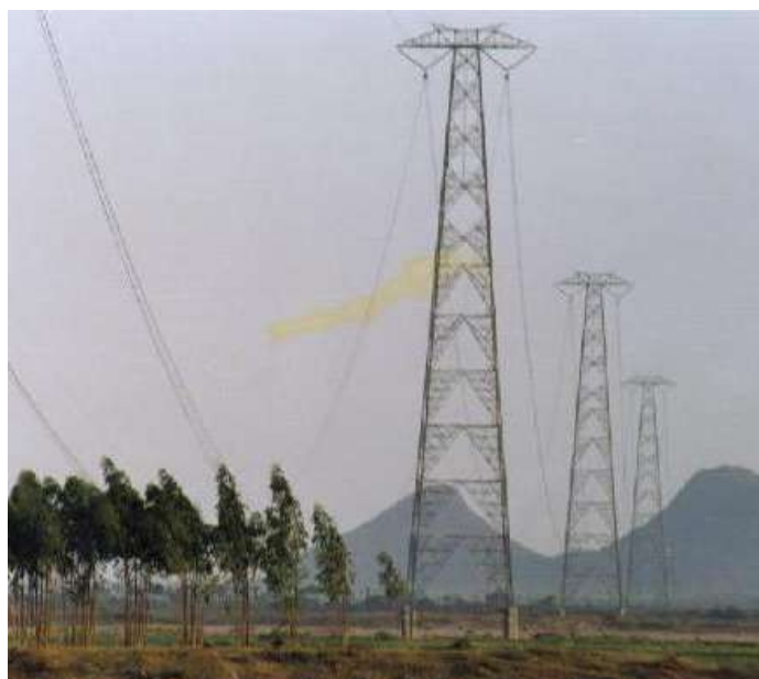
Фото 1: Линия высокого напряжения постоянного тока после завершения строительства
